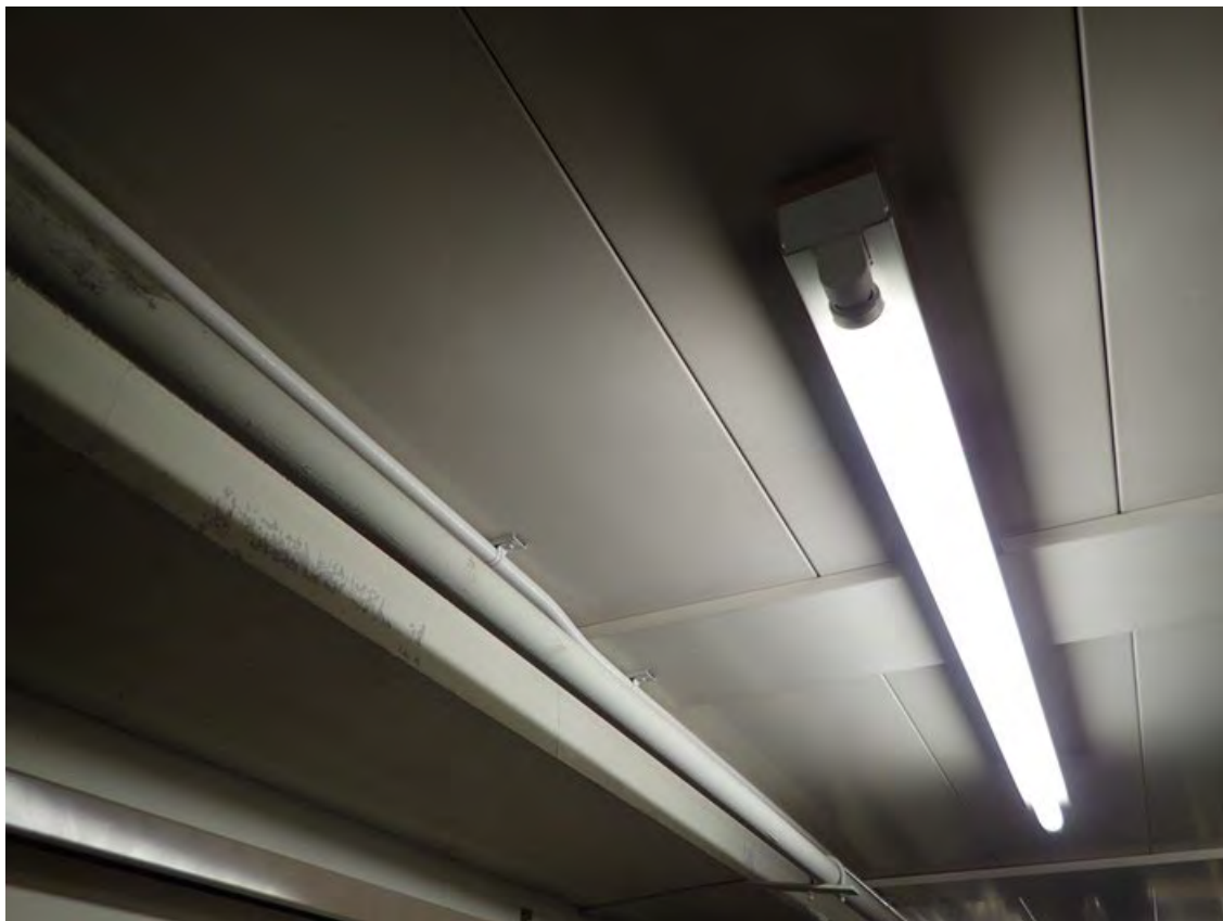
天井からの漏水
